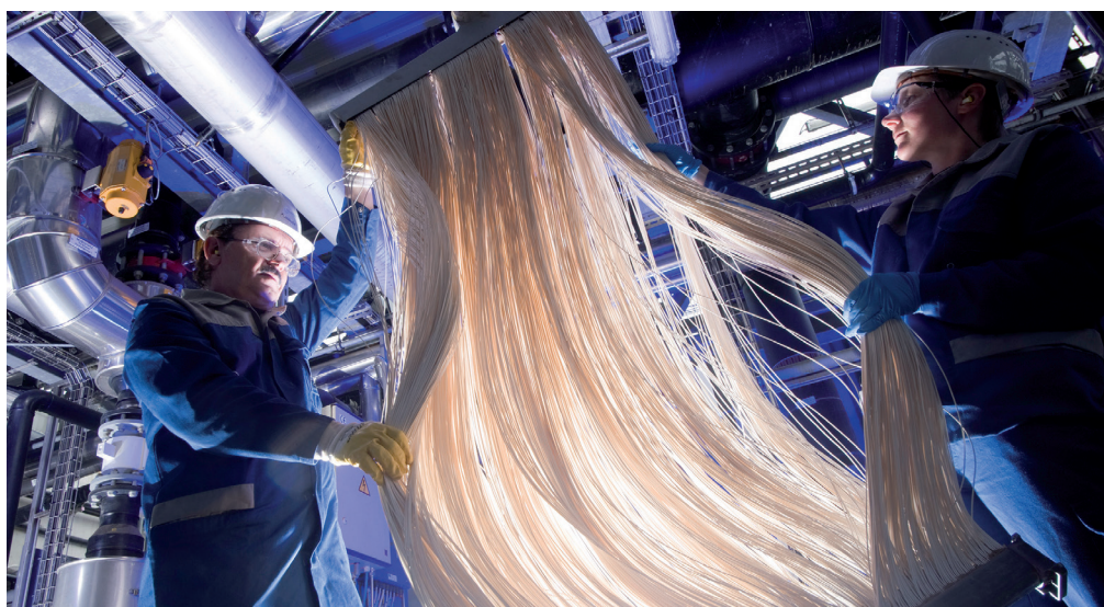
Hohlfasermembranen in der industriellen Abwasseraufbereitung (© Bayer Pharma AG)
